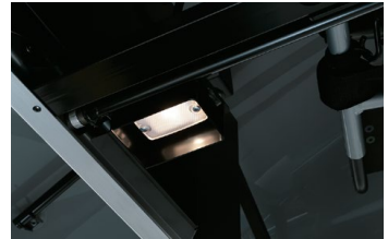
夜間照明灯(ウェルキャリア内側)
