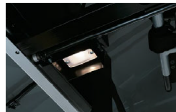
夜間照明灯(ウェルキャリアー内側)
