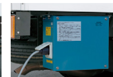
電源コンセント(3相AC200V用)
